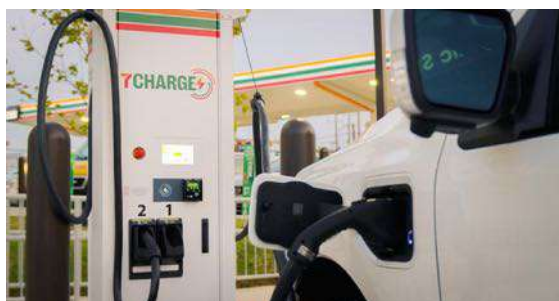
EV充電ステーション
