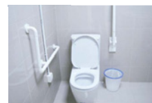
広いスペースの中で、便器や 手すりの設置などを工夫したトイレ
