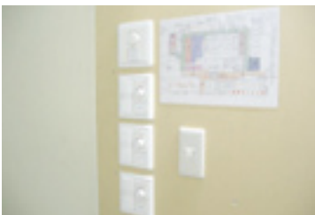
照度を補正する連続調光設備
