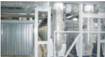
夜間電力で氷を作る氷蓄熱システム
